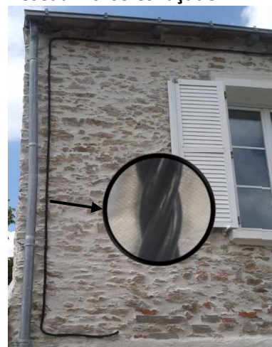
Réseau fils isolés façade BT
