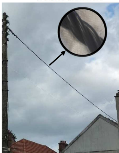
Réseau fils isolés aérien BT
